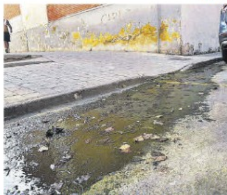
El vertido de aguas fecales de la calle 10 del barrio Carbonaire sale por debajo de la acera y su flujo es permanente desde hace semanas.
